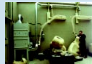
Установка с дополнительной взрывозащитой в мастерской скульптора.
